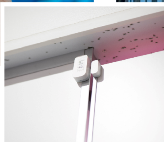
設置されたGravioセンサー
